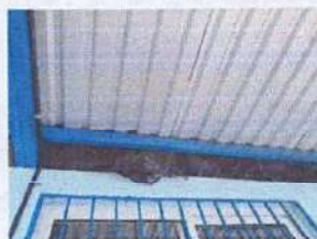
Foto 4: Sustrucción de cedazo en area de aula por daño por palomas
