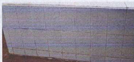
Foto 5: Sustrucción de azulejo en pileta
