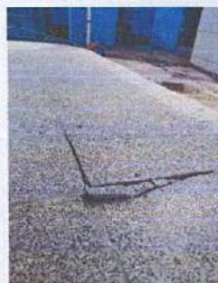
Foto 6: Sustrucción de piso de granito por fisuras
